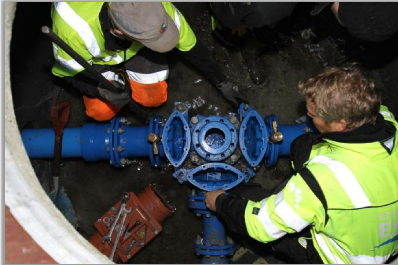
Ventiltopper demonteres for å kunne få Ventil – T ut av Ø650 mannhull. (Lysåpning ca 580mm)
